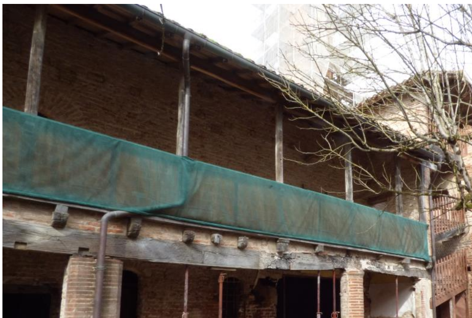
Figure 4 : Filet de protection provisoire installé pour palier la chute des briques de remplissage du garde-corps de la galerie haute
