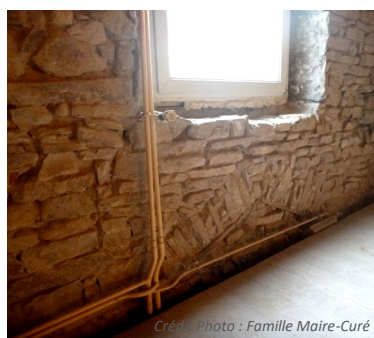
MISE À NU DU MUR EN PIERRE ET DES RÉSEAUX EN INTÉRIEUR AU 1ER ÉTAGE
